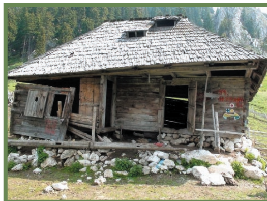
refugiul din Curmătura Builei înainte de reconstrucție și reamenajare
